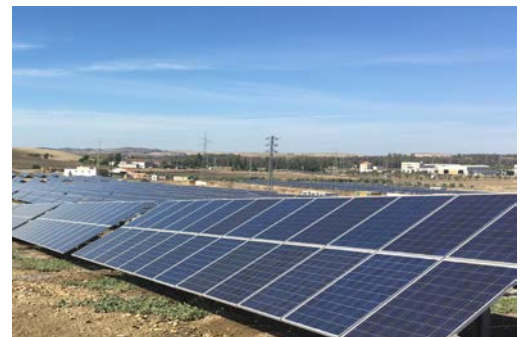
Foto: Planta fotovoltaica de 2.2 MW in Villamartín, Cádiz, España gestionada por Optimal Sun, partner de Mercado de Alectris.
