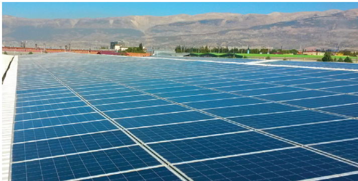
L'IMPIANTO, COMPOSTO DA 2.941 MODULI, PER UNA POTENZA DI 750 KWP, E 41 INVERTER, È DISTRIBUITO SU UNA SUPERFICIE DI 30MILA METRI QUADRI
