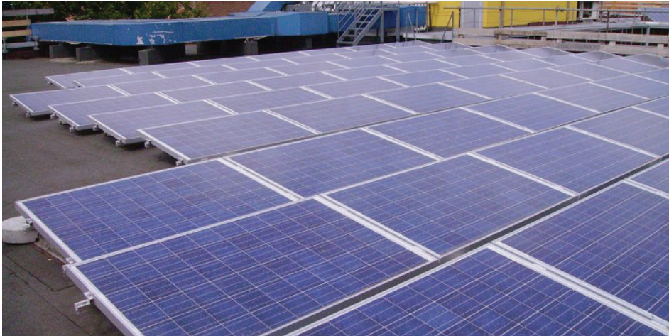
SUI TETTI DEGLI EDIFICI PUBBLICI SONO STATI REALIZZATI 18 IMPIANTI FOTOVOLTAICI COSTITUITI DA MODULI SOLON E SUNTECH E COLLEGATI A INVERTER ABB
