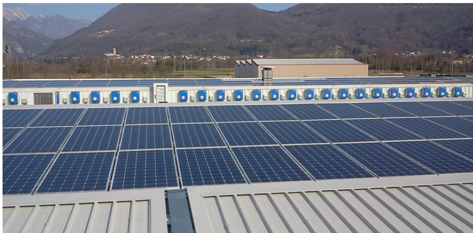
IL PRODUTTORE DI PIZZE SURGELATE RONCADIN DI MEDUNO (PN) HA INSTALLATO UN IMPIANTO FOTOVOLTAICO SUL TETTO LA CUI PRODUZIONE ANNUA SODDISFA IL 7% DEL FABBISOGNO ELETTRICO
